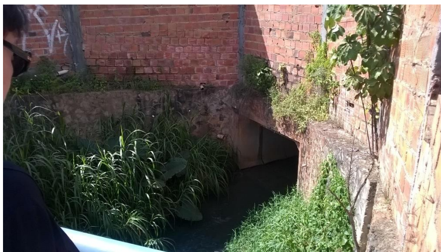
Figura 25 - Ocupação sobre o riacho Mané Dendê canalizado.
